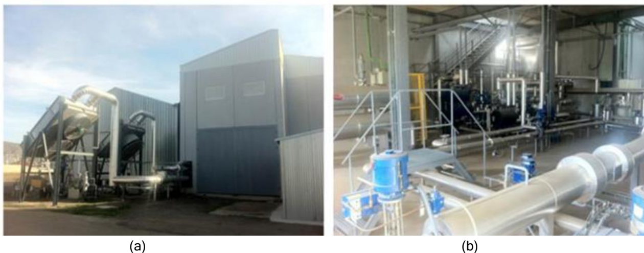
Figura 29. Vista exterior del edificio CSP+D con enfriadores de aire (a) y vista parcial del interior del banco de ensayo CSP+D (b).
