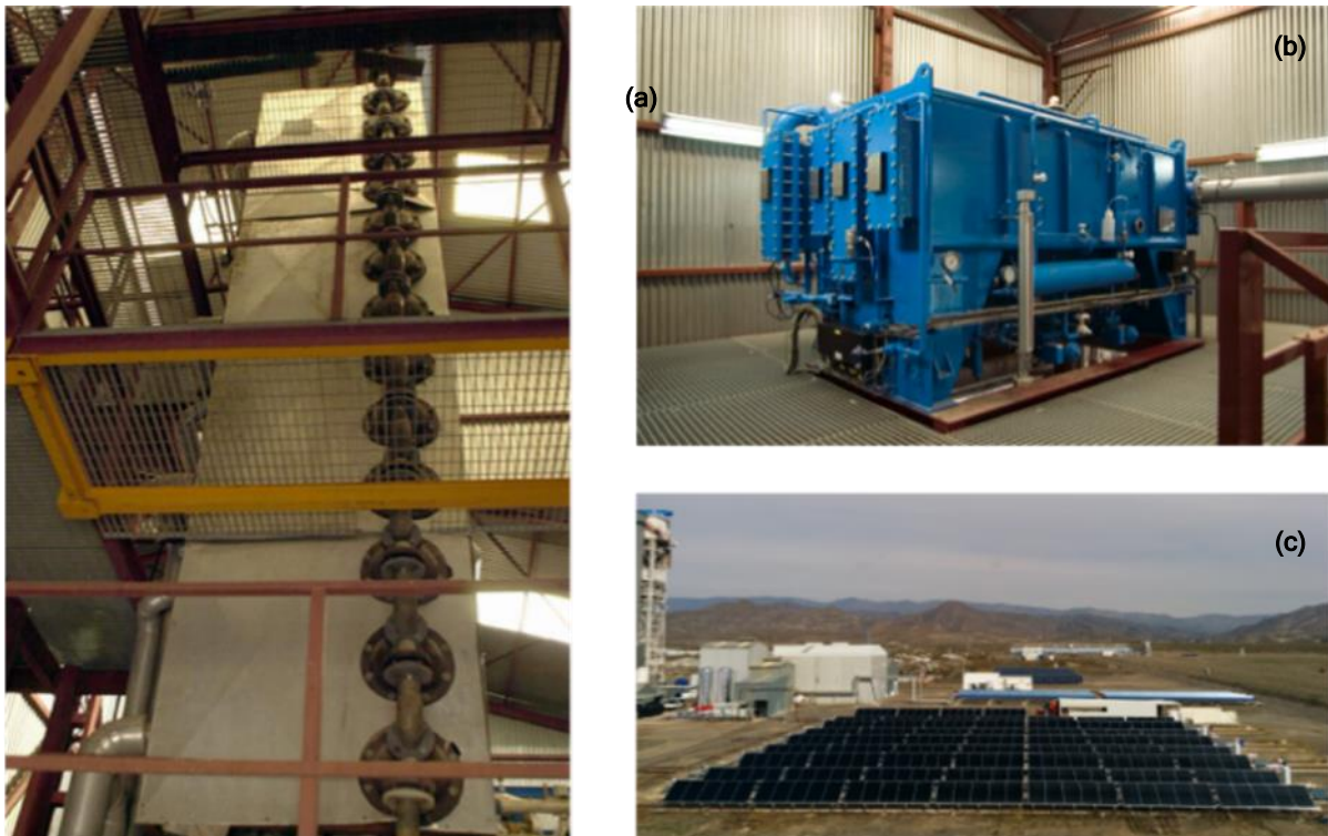
Figura 27. Planta SOL-14 MED de PSA (a), bomba de calor por absorción LiBr-H 2 O (b) y campo solar de 606\text{-m}^2 de captadores planos (c).
