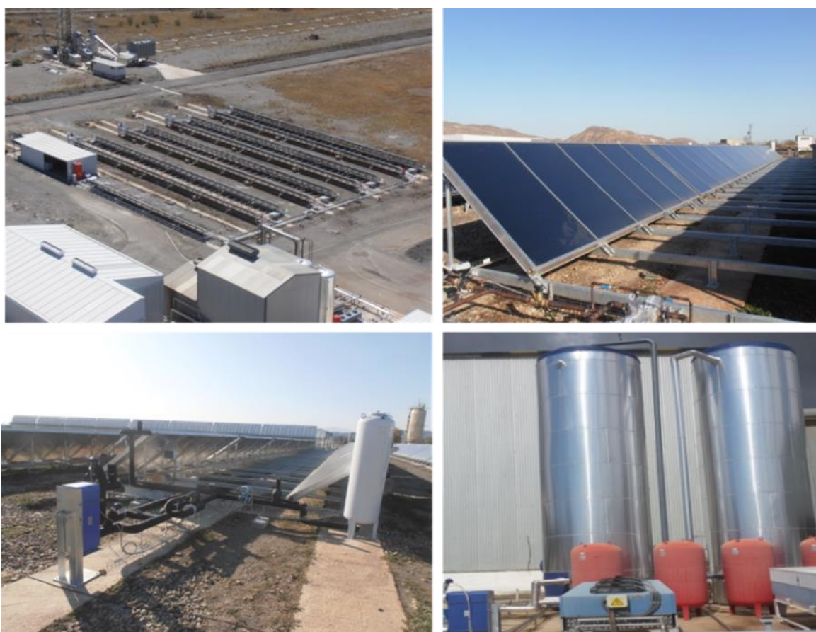
Figura 28. Campo solar de 606-m 2 de captadores estáticos (AQUASOL-II).
